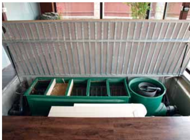
Filtrácia je šikovne ukrytá pod mólom a neruší tak atmosféru jazierka
